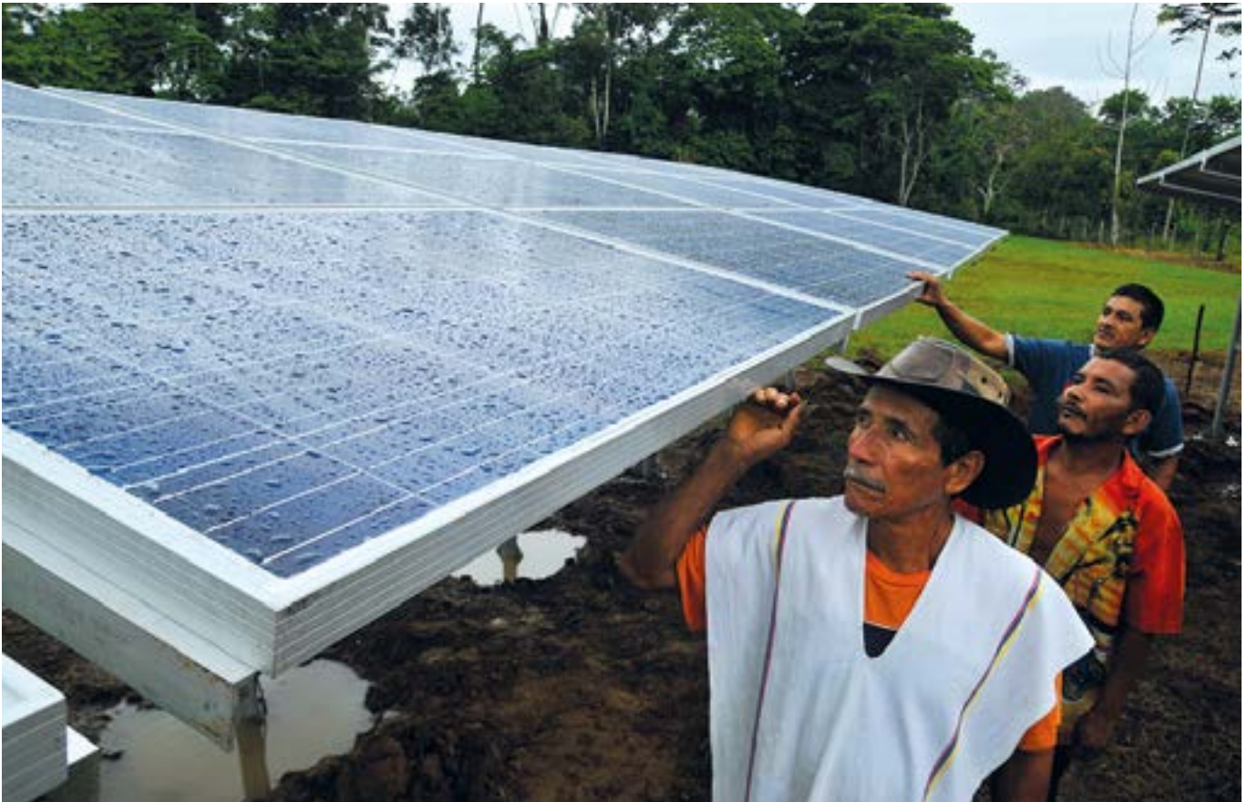
Dirección para el Desarrollo y la Integración Fronteriza, Proyecto de paneles solares, vereda de Sucumbíos (Putumayo), mayo de 2016. Fotografía: Julián Lineros C.
